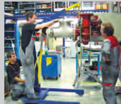
Révision complète et rééquipement du matériel d'extinction, contrôle des réservoirs et test de fonctionnement.
