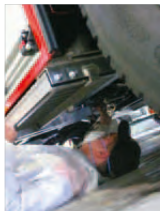
Traitement curatif et préventif contre l'oxydation.
